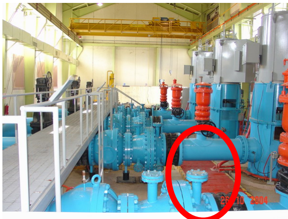
Fotografía 2. Instalación normal de la válvula expulsora de aire a la descarga de las bombas.
