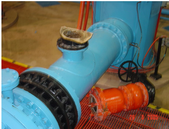
Fotografía 1. Accidente de fractura de una válvula de compuerta de 10" clase 125
